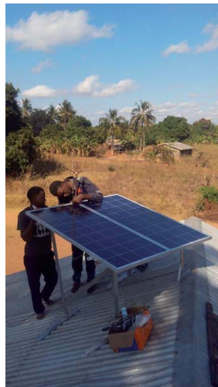
Mitarbeiter der Fa. Ensol Ltd installieren Solarmodule auf dem Dach der Gesundheitsstation Kanyimbi in Masasi Stadt. Foto: TAREA
